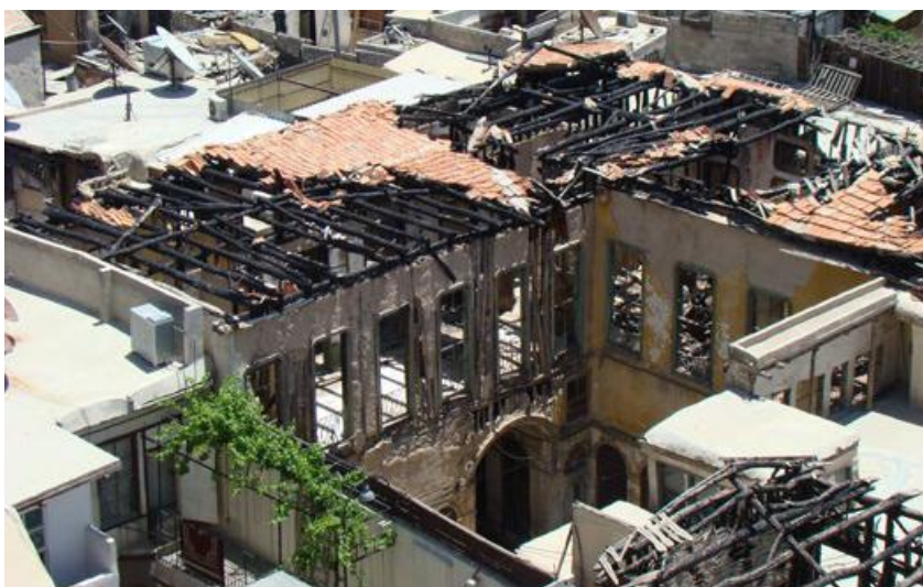
Bâtiment patrimonial endommagé par le feu. (Image : Firas Otman)
