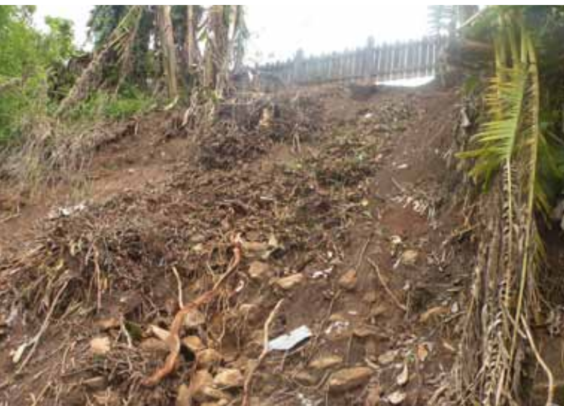
Photo 6 : Talus effondré. © Marie Hortense Razafindramboa
