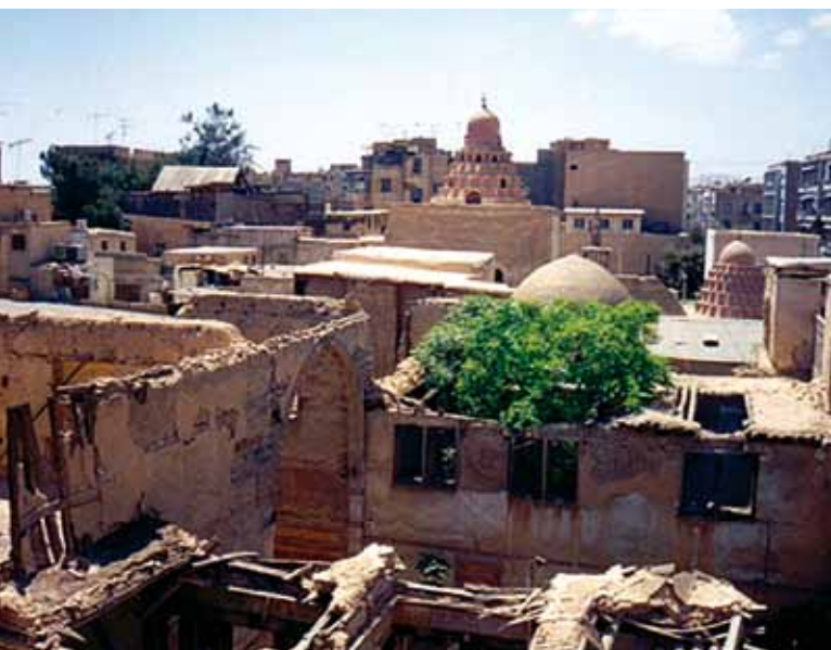
Photo 6 : L'état d'abandon de la Bayt al-Āidi située à deux pas de la grande mosquée de Damas et de la madrasa an-Nouriyah. En arrière-plan, les immeubles du quartier de Hariqa –ancien quartier Sidi Āmoud. © A.Soufan
