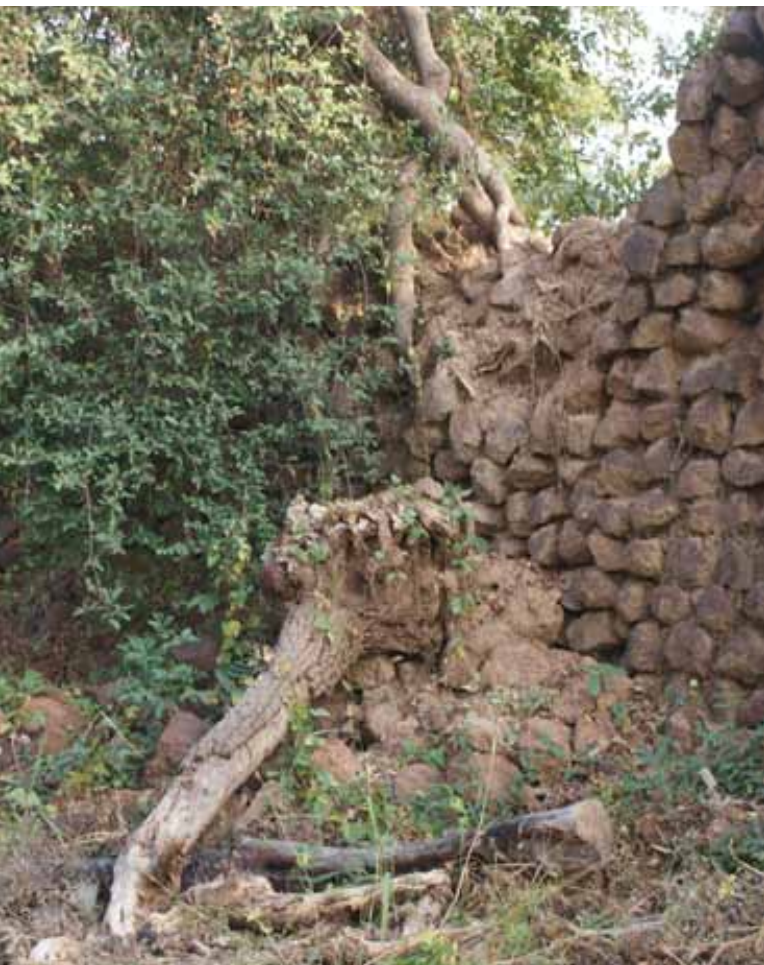
Figure 9 : Problèmes causés par les arbres. © L. Simporé
