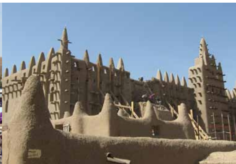
Figure 2 : La mosquée de Djenné pendant les travaux de restauration de 2009. © CRAterre / T. Joffroy
