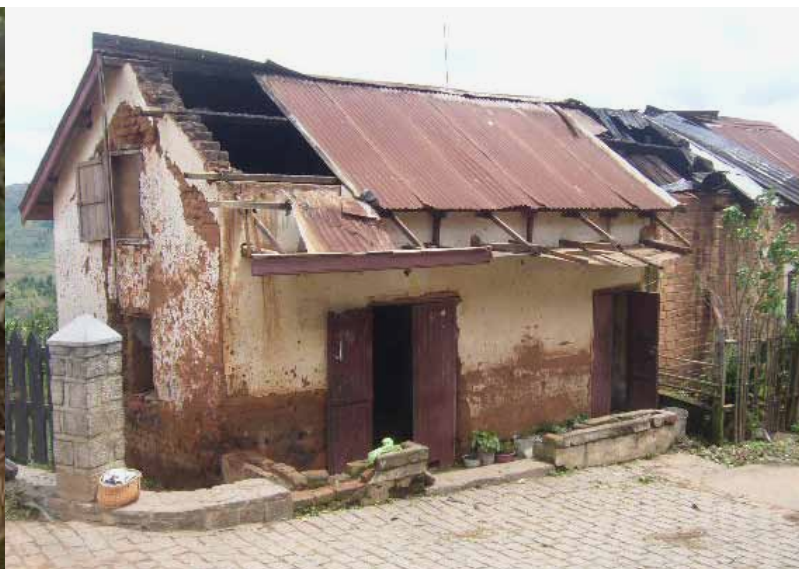
Photo 7 : Toiture emportée. © Marie Hortense Razafindramboa
