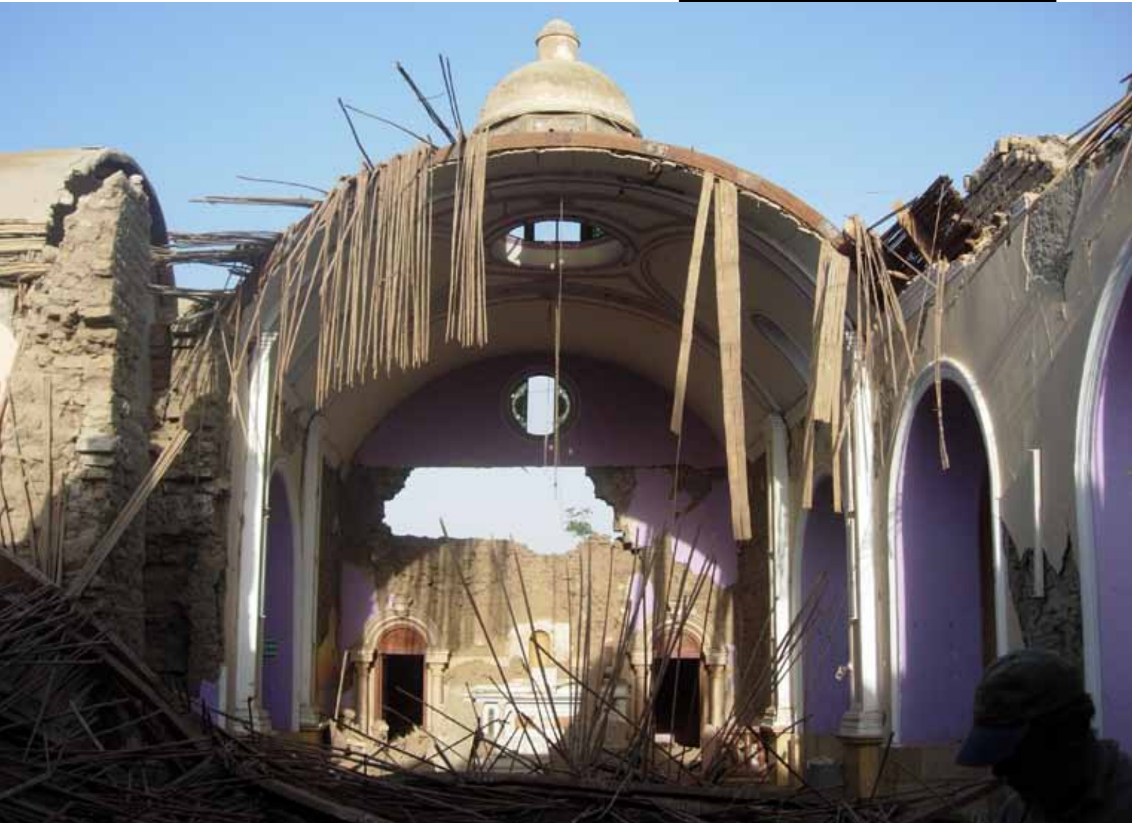
Etat de l' église de Humay suite au séisme de Pisco au Pérou, août 2007. Photograph taken during evaluation mission organized by the Getty Conservation Institute. © CRAterre / P. Garnier
